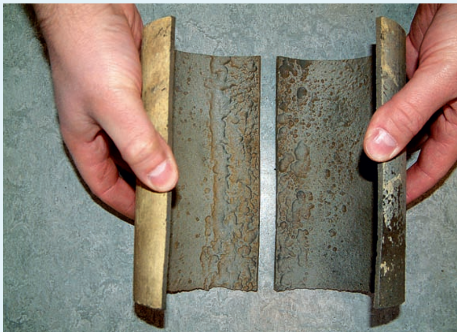
Figur 6. Typiska korrosionsangrepp på horisontella rör efter bortblästring av grafiteringsskiktet. Lägg märke till de djupare korrosionsangreppen med många lokala korrosionsangrepp med olika frätdjup i rörets nedre del.
